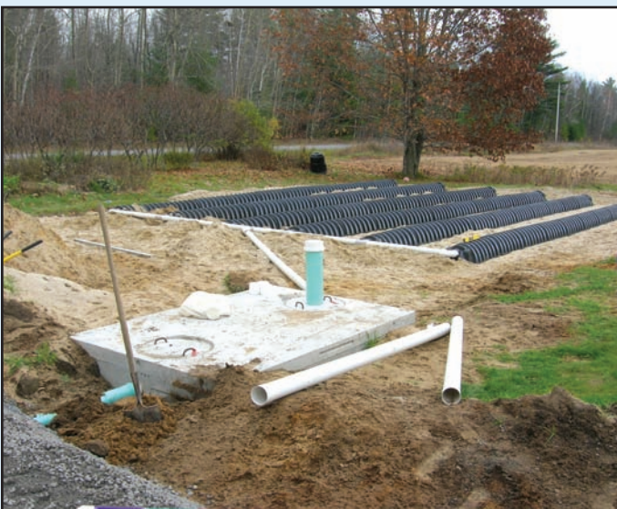
Champ d'épuration avec technologie de tranchée sans gravier
