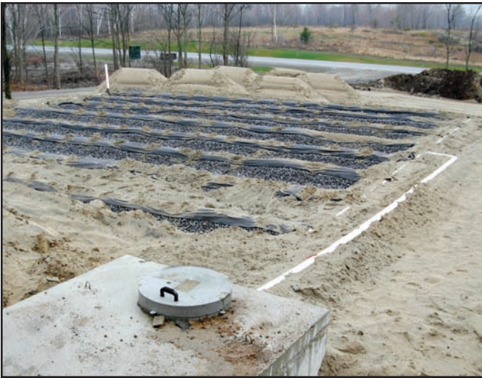
Champ d'épuration avec tuyaux perforés en PVC
