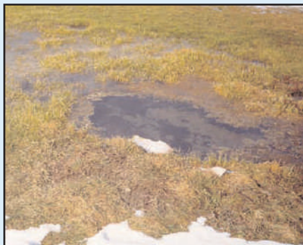
Accumulation d'effluent à la surface du champ d'épuration
